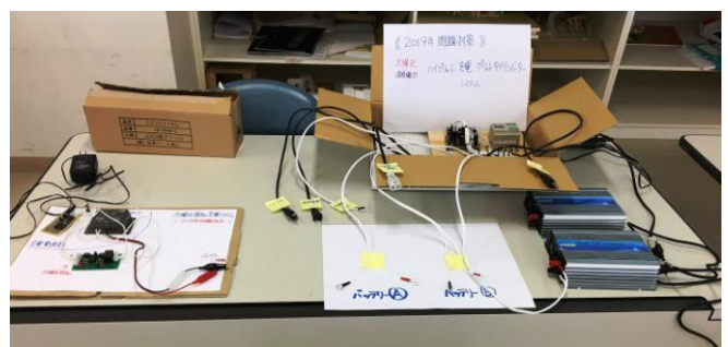
第4回農業・福祉・エネルギー交流会に出展されたバッテリー制御システム
