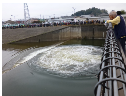
大和田機場 試運転の放水
