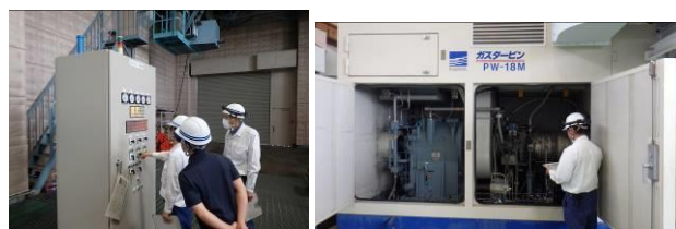
平常時の機器点検作業
